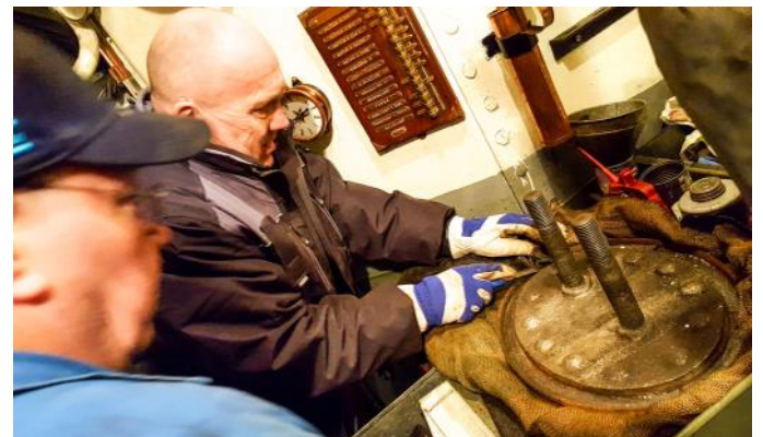
Packning avlägsnas från pannans lägre manlucka.
